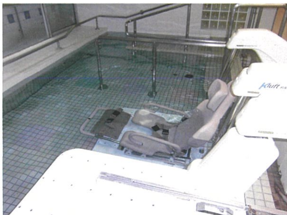
地下1階／浴室（リフト浴完備）
